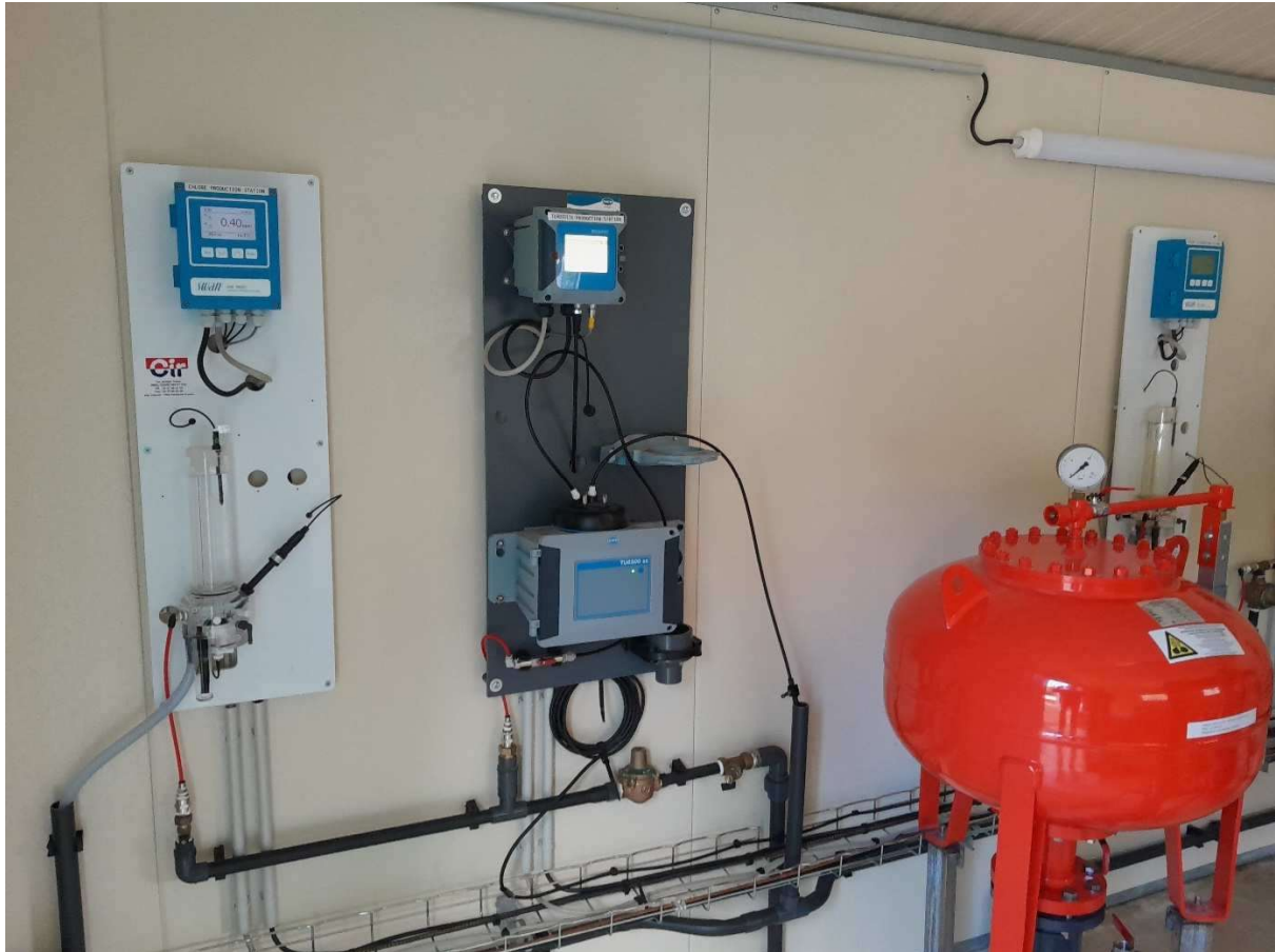
Figure 81. Analyseur de chlore en continu et suivi de la turbidité de l'eau prélevée à Font Pétugue à l'intérieur du nouveau local technique
