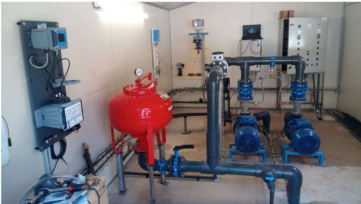
Figure 80. Intérieur du local technique intégrant les équipements de traitement de l'eau prélevée à Font Pétugue
