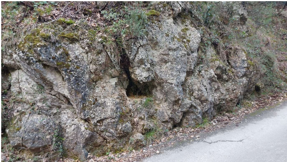
Figure 59. Zone de vide observée sur la route menant au hameau de Vigne Groussière
