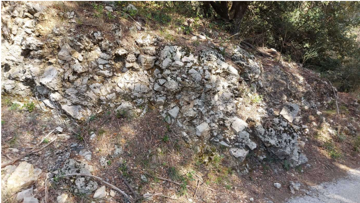
Figure 57. Brèche affectant les calcaires gris du Trias moyen, et associée à une perméabilité élevée
